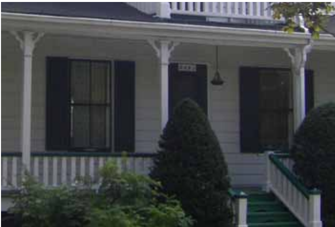
Fig. G.04. Ouvertures rectangulaires sans linteaux ni allèges, avec fenêtres à guillotine, observables au 2445, rue Saint-Pierre Ouest.
